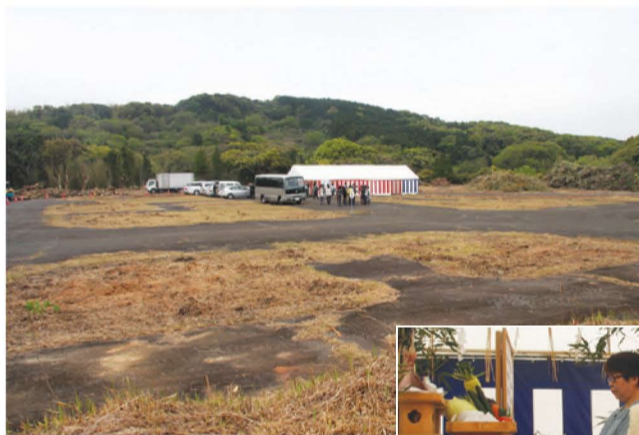
建設予定地は造成がすすみ、出力1057kWになる太陽光パネル(4228枚)が敷き詰められたようすをイメージできるまでになりました
