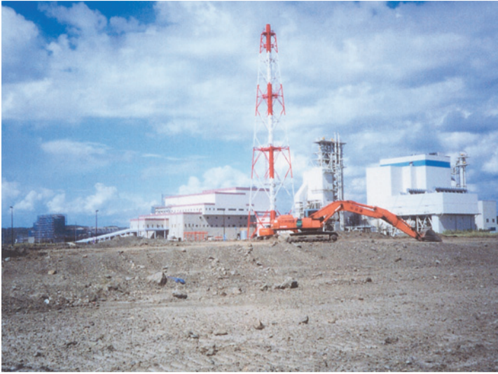
2002年建設中の大牟田エコタウン施設
