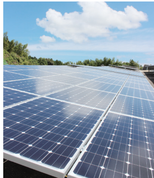
神在太陽光発電所
